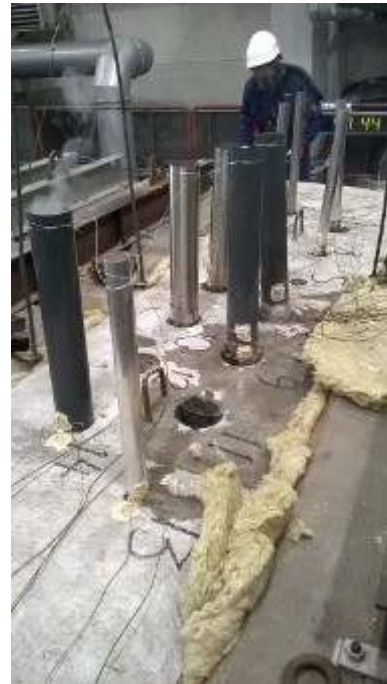
Näkymä testiuunin päällä. Testattavat kaivot on numeroitu testilaattaan.
